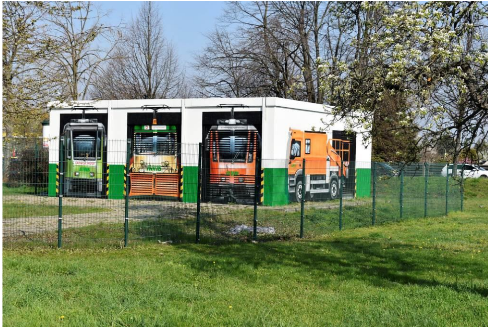
Unterwerk am Europaring
