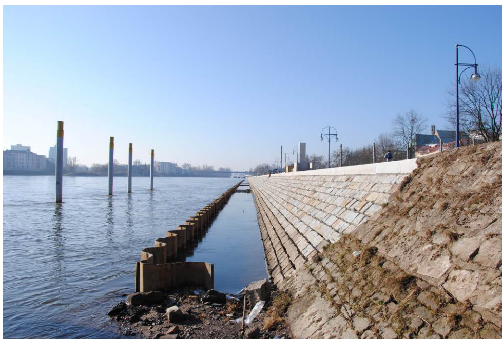
Neue Böschungsmauer. Die Spundwand, die vor der Steinmauer zu sehen ist, wird noch zurückgebaut. Dafür ist Niedrigwasser notwendig.
